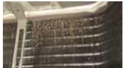
* 열교환기오염 | 효율저하로 인한 전력소모량 증가
